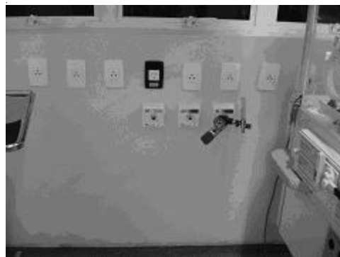
Figura 2 - Foto da instalação da rede de oxigênio, vácuo e ar comprimido, na UTIN
